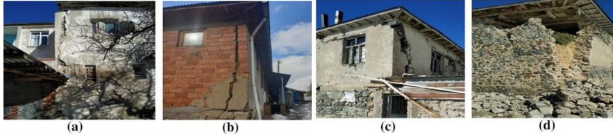
Resim 1. Sivrice kasabesindeki yığma yapılarda köşe göçme mekanizmaları [16]
